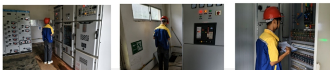
用电安全隐患排查及汛期电房渗水排查
