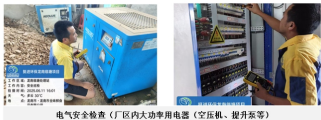
电气安全检查（厂区内大功率用电器（空压机、提升泵等）
