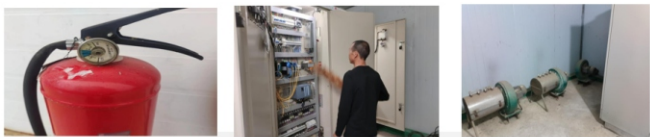
全面检查并更换不合格灭火器
